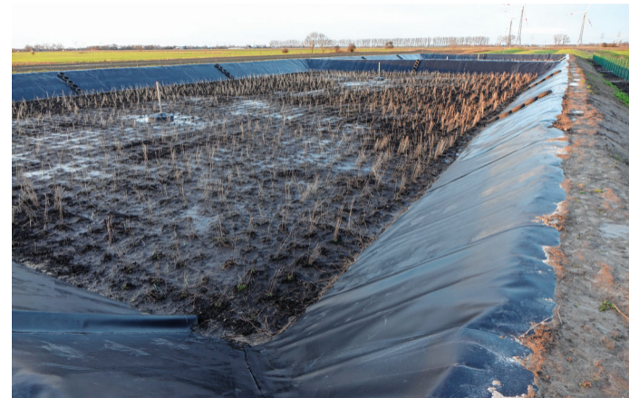
In zwei Beeten soll der Klärschlamm zukünftig aufgebracht werden.
